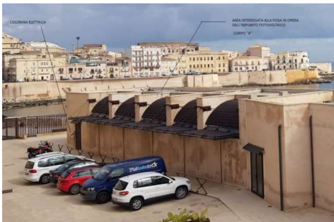
CORPO "A" – nuovo Impianto fotovoltaico
