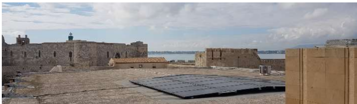
Impianto fotovoltaico esistente
